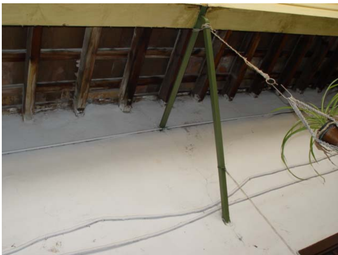
Foto 16. Patología. Forjados de madera zonas comunes.
