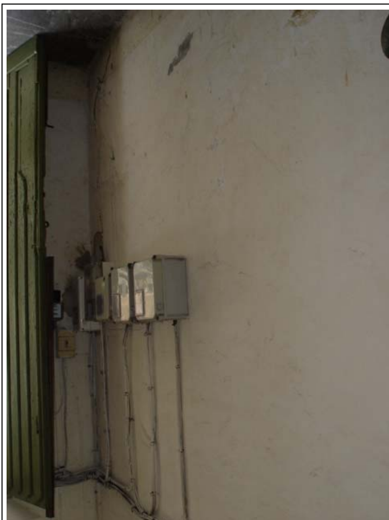
Foto 7. Vista de contadores de electricidad.
