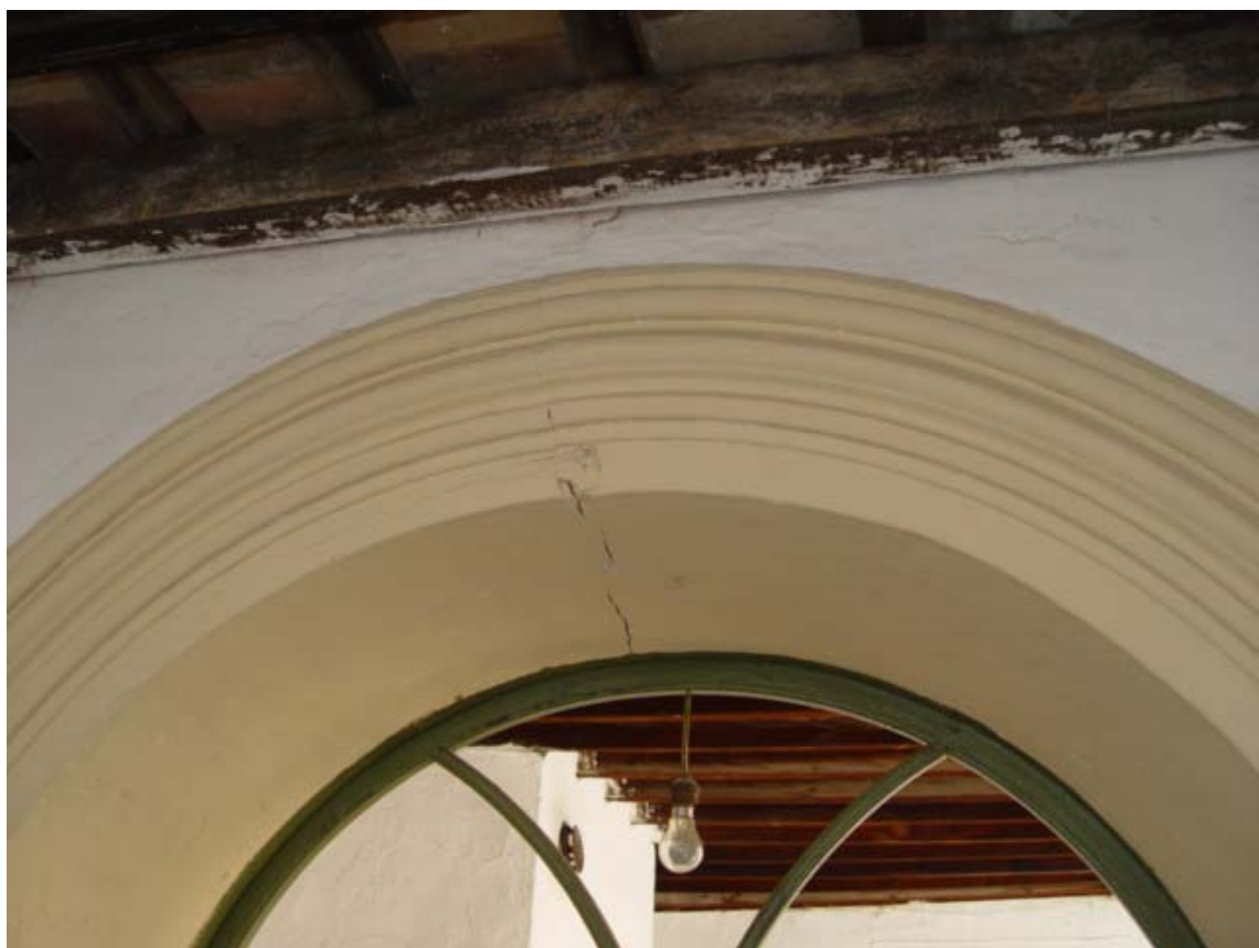
Foto 12. Patología. Claves de arco de escalera.
