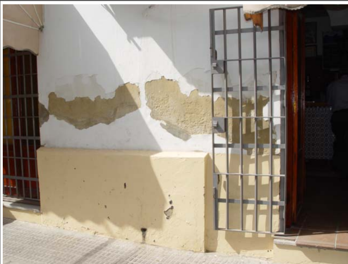
Foto 25 Capilaridad en planta baja.
