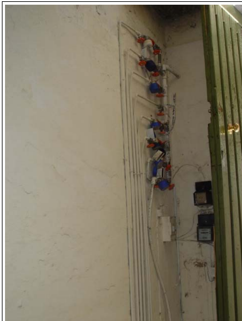
Foto 8. Vista de contadores de agua.
