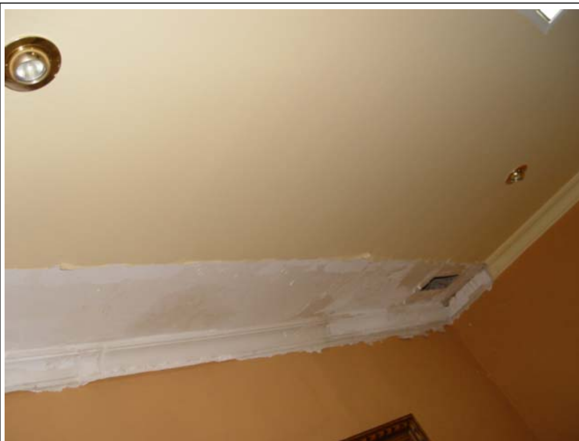
Foto 24 Humedades sobre local peña desde patio.
