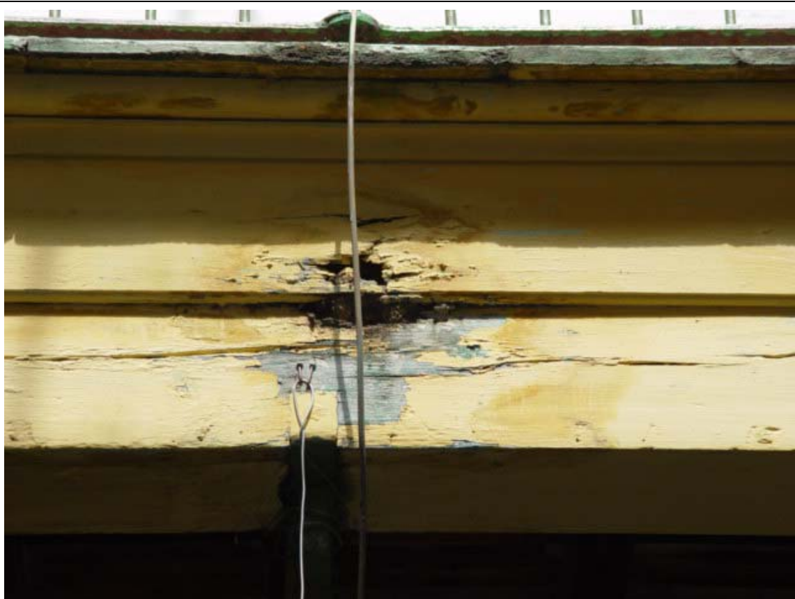
Foto 13. Patología. Vista de vigas de patio.
