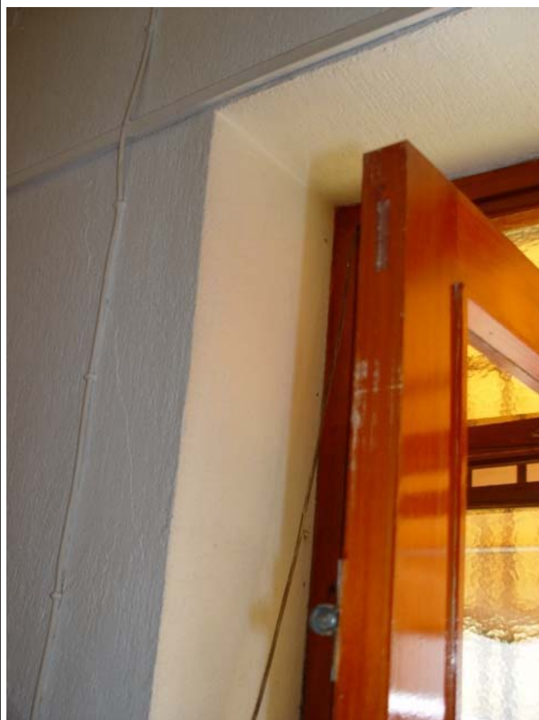
Foto 28 Fisura en cargadero de planta baja.
