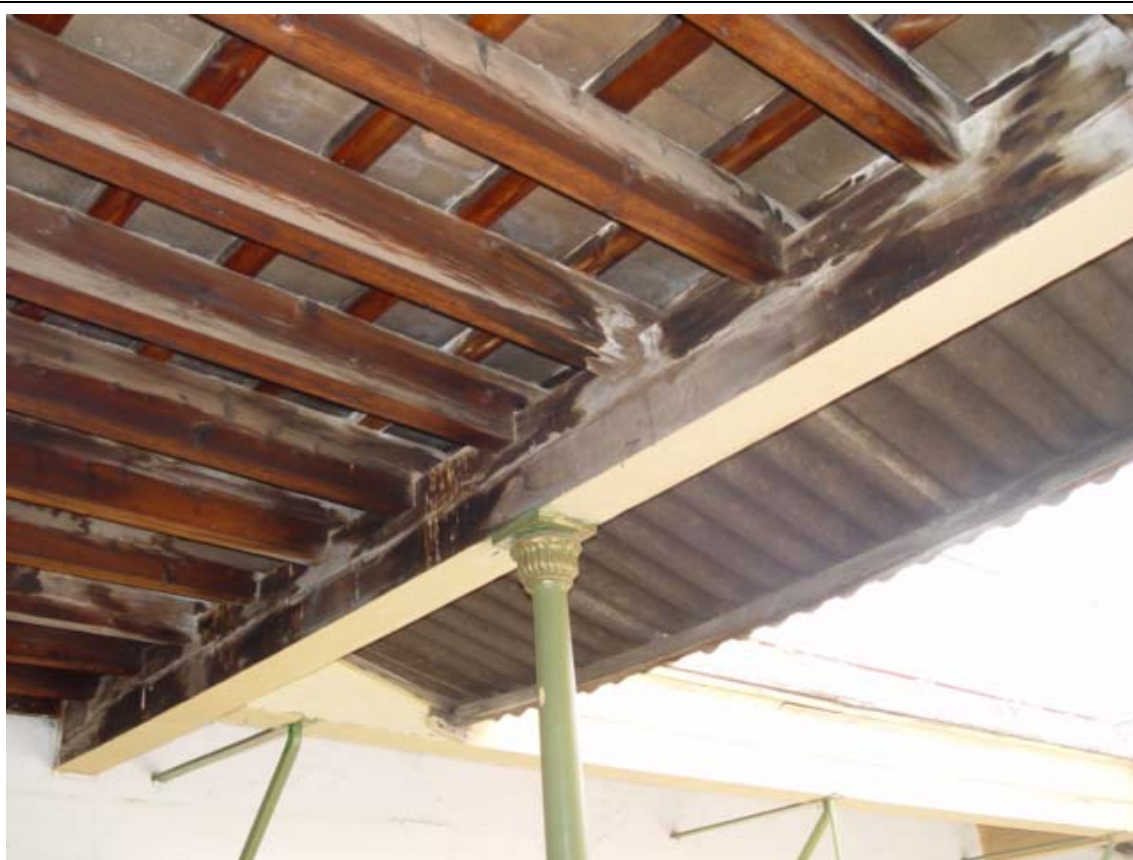
Foto 15. Patología. Forjados de madera zonas comunes.
