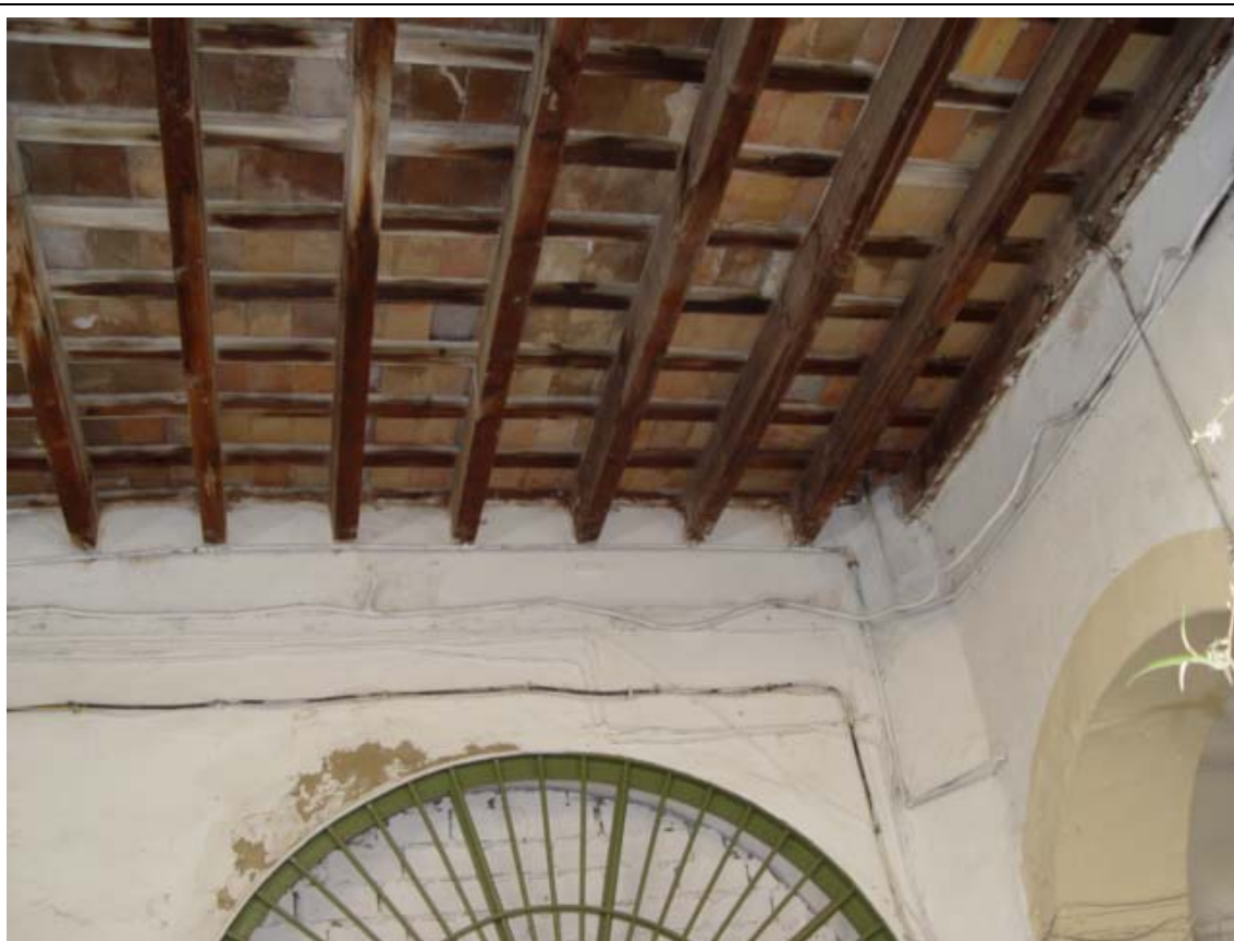
Foto 14. Patología. Forjados de madera zonas comunes.
