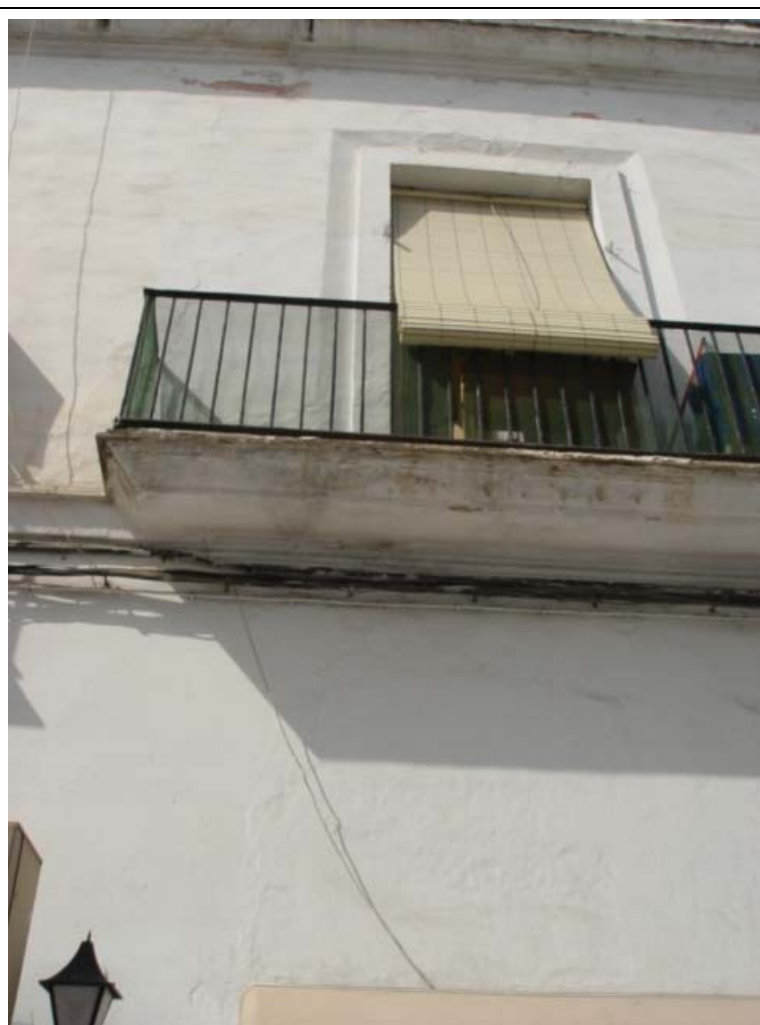
Foto 29 Fisura en vertical en toda la fachada alineado con cargadero.
