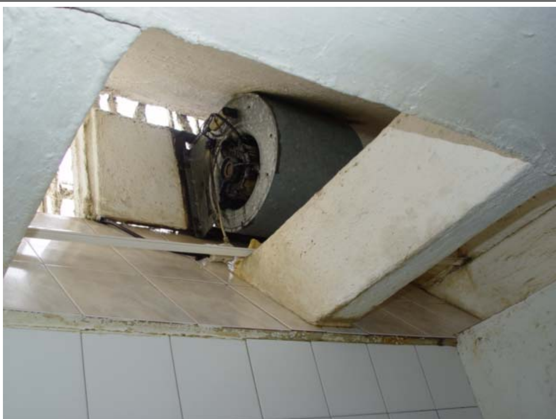
Foto 27. Interior Locales. Deficiencias sanitarias y ruidos
