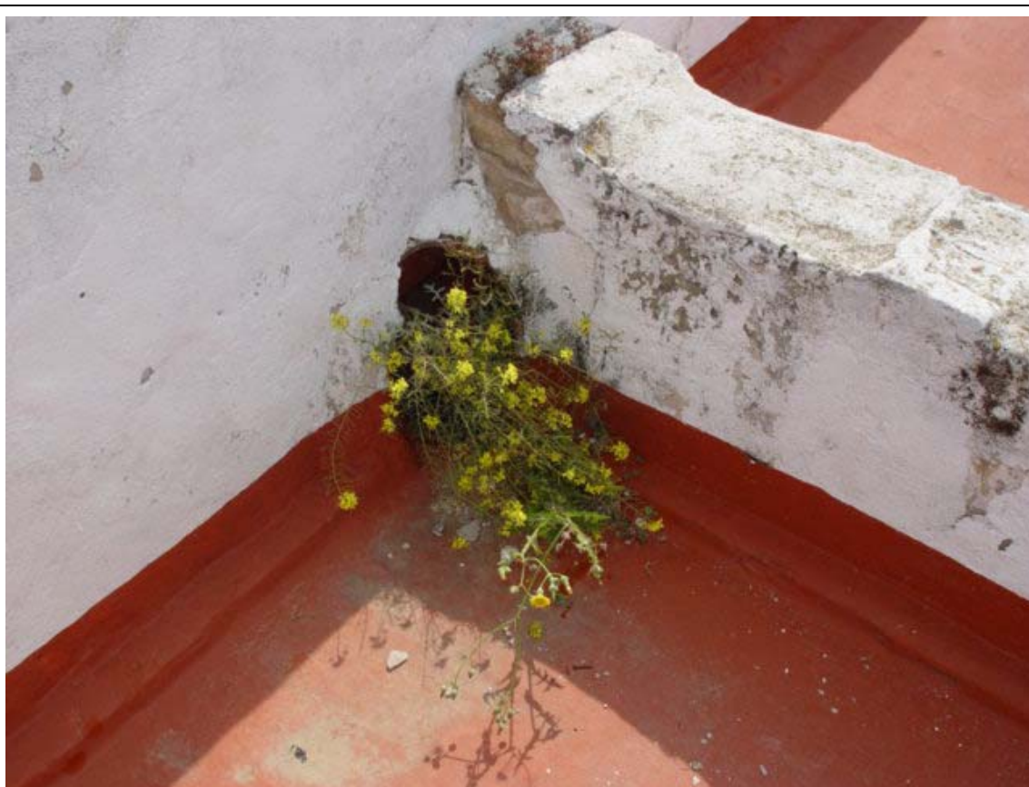
Foto 20. Mantenimiento inadecuado de cubiertas
