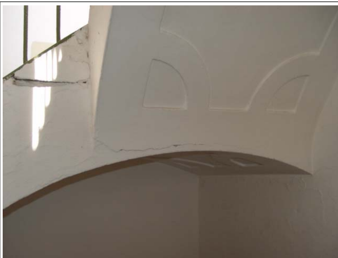
Foto 16. Patología. Bóvedas de escalera.
