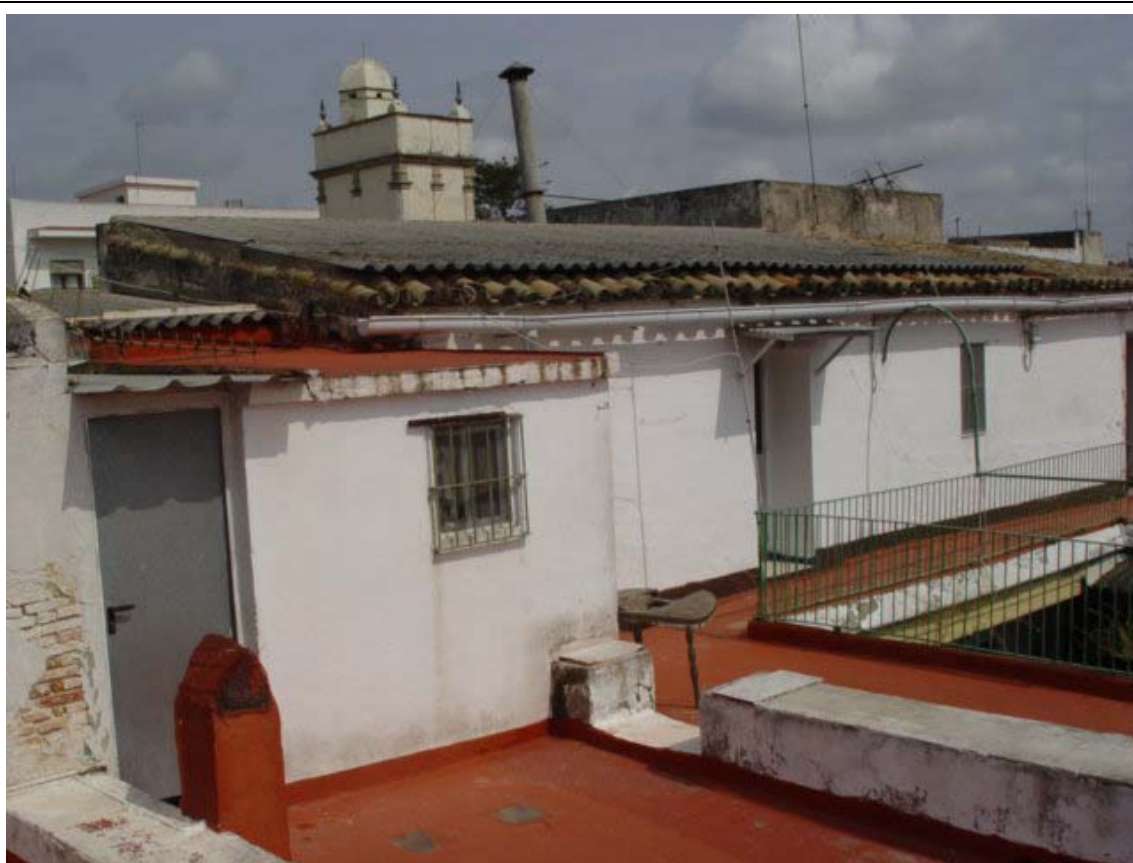
Foto 21. Patología. Edificaciones ruinosas en cubierta. Chapa de fibrocemento con amianto sobre tejas.
