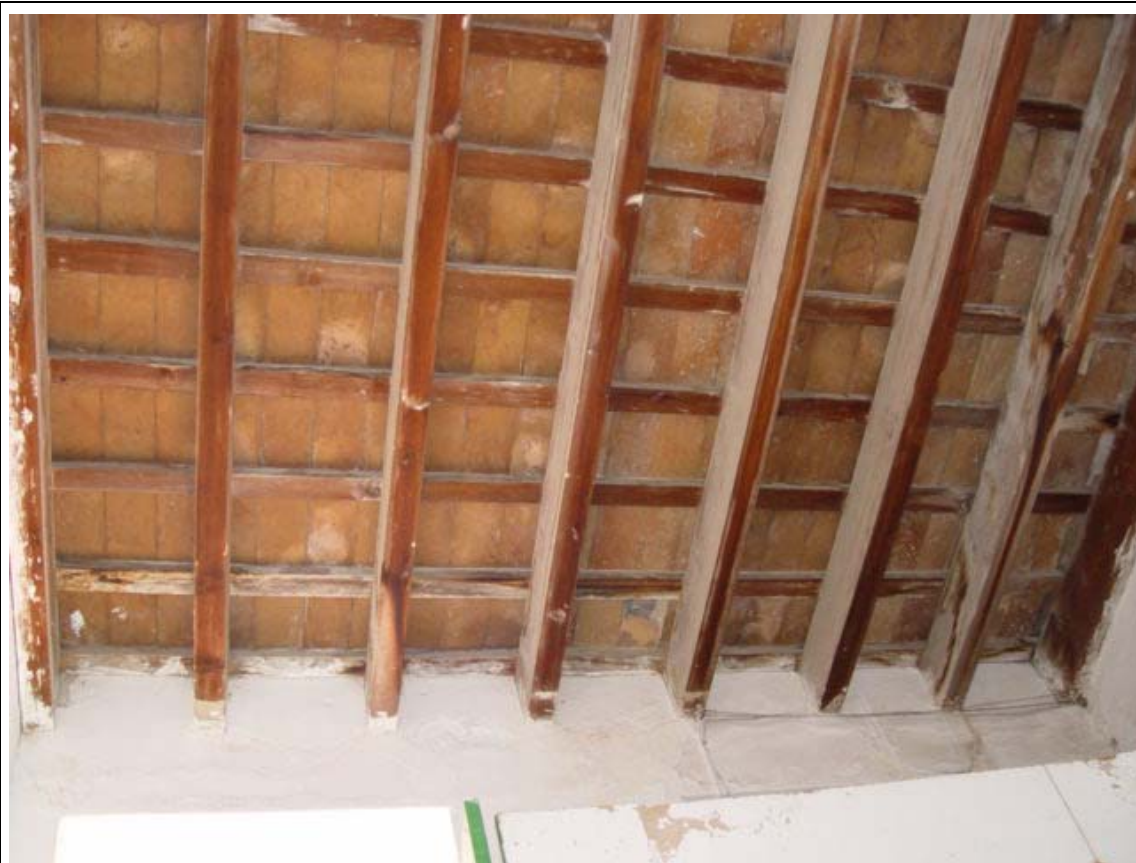
Foto 17. Patología. Forjados de madera en castillete.
