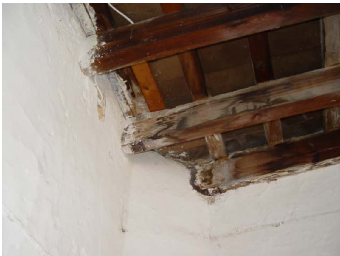
Foto 17. Patología. Forjados de madera zonas comunes.
